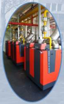
Nieuwe HR-ketels (gerealiseerd)
